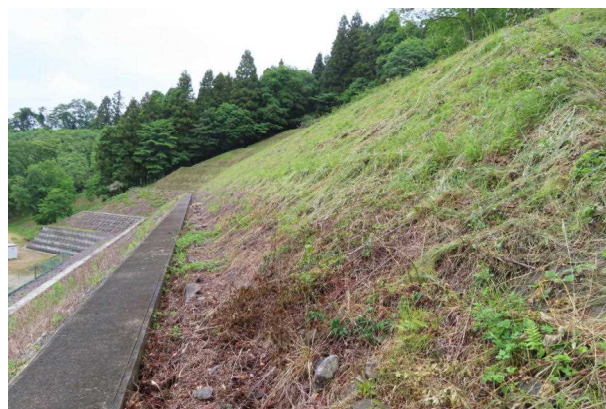
きれいになった法面
